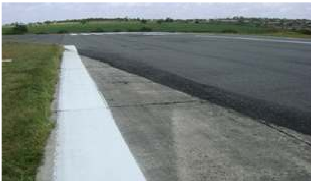
Foto 1:degrau existente na lateral da pista principal
